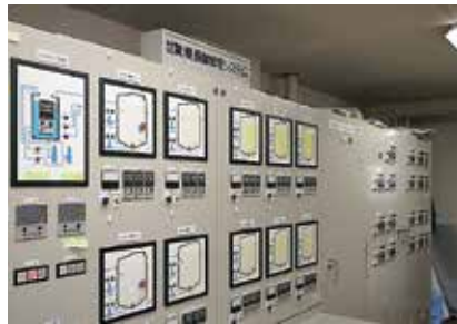
自社発酵管理システムの制御室
